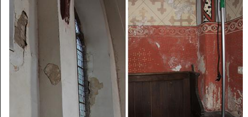
Schadensbilder der Gützkower Kirche
